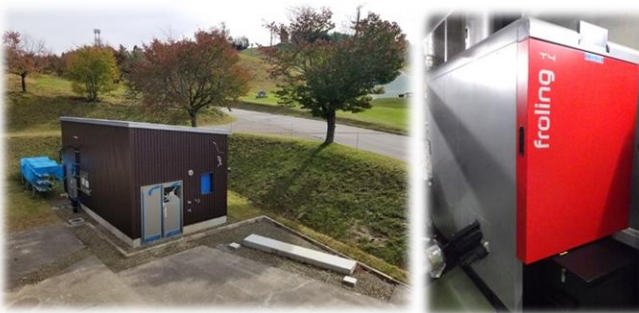
左：つべつ木材工芸館「キノス」ボイラー施設 建設中 右：導入予定の木質バイオマスボイラー
